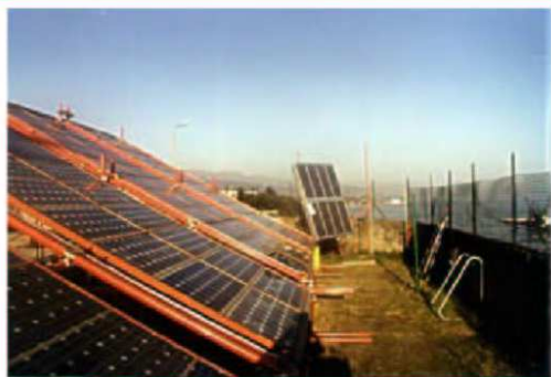
Impianti fotovoltaici: Centrale e inseg. automatico del sole
